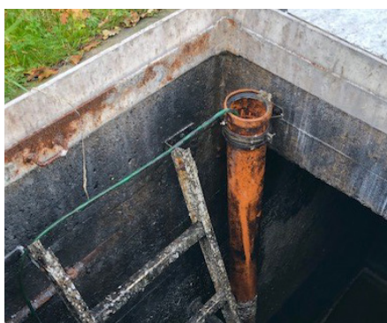
pHix® Compact monteret i brønd i PVC rør for at skærme kablet og gøre vedligehold og kalibrering lettere tilgængelig.
